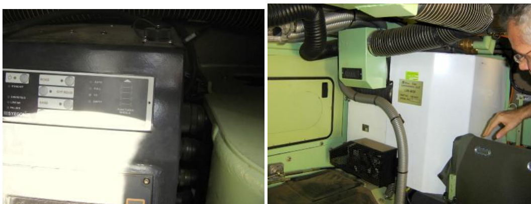
À esquerda, sistema de enchimento dos pneus e à direita sistema QBN. (Fotos: autor)
